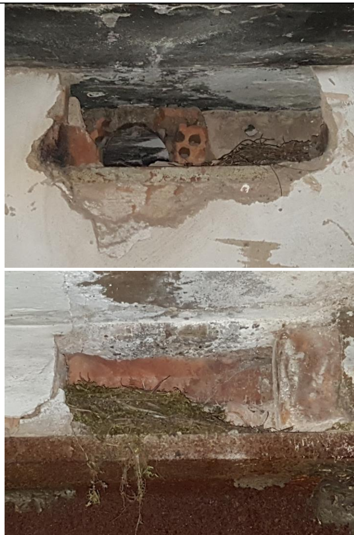
Abb. 23: Vogelnester innerhalb des Gebäudes
