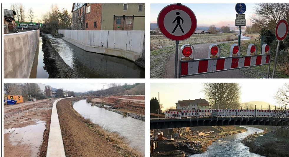
Hochwasserschutzwände sind sowohl an der Einmündung des Mühlgrabens (links oben), als auch entlang des Opel-Werks (links unten), gebaut worden. Weiterer werden demnächst auf der rechten Seite der Hörsel ab Hörselschule bis Opel-Brücke gebaut. Der dortige Weg ist deswegen gesperrt (rechts oben). Parallel laufen die Bauarbeiten an der neuen Hörselbrücke im Zuge der Friedrich-Naumann-Straße (rechts unten).
