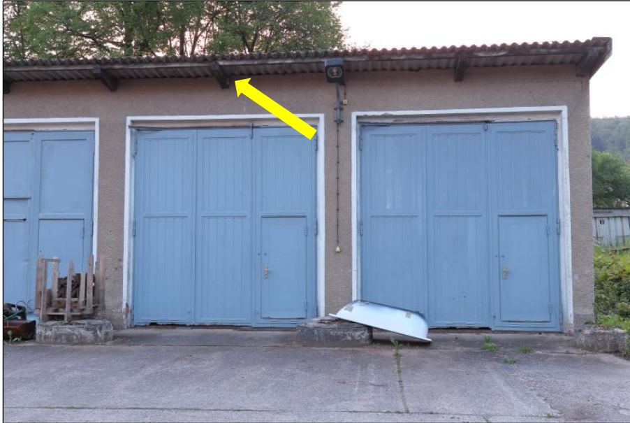
Abb. 19: Großgarage Firma Schaub. Einschluöffnung für Steinmarder
