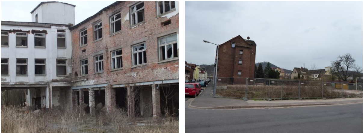
Abbildung 47 / 48 Verfallene Gebäude und Brachflächen im Stadtteil Oppenheimstraße
