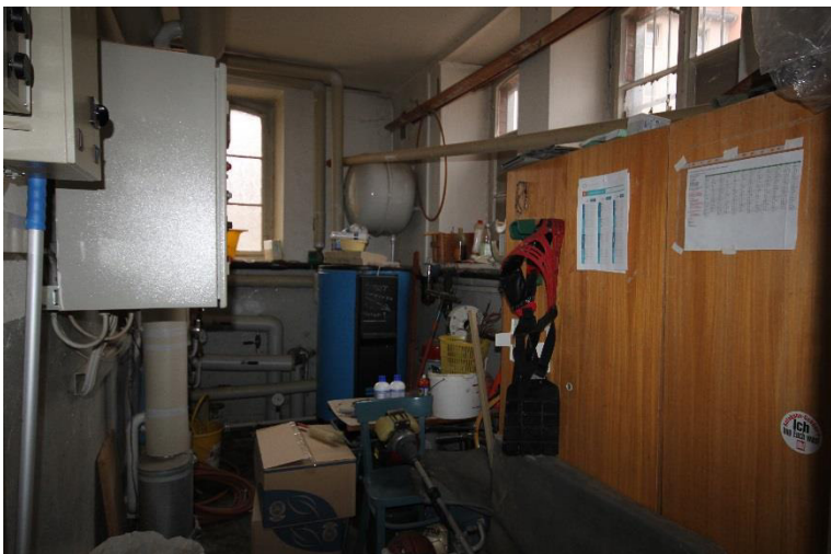
Technikraum in der Bestands-Sporthalle
